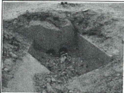
Foto 04: Ingreso de alcantarilla de desfogue en inicio de tramo, dos tuberías Ø 8" cada una. Cabezal de ingreso en malas condiciones y obstruido.
