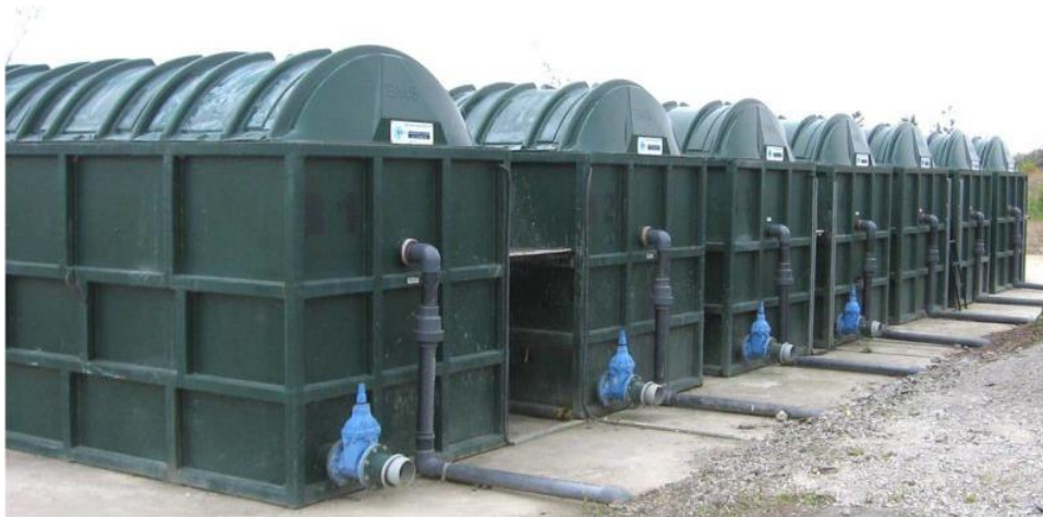
Imagen 88: EJEMPLO DE TANQUE BIORREACTOR
